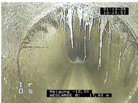
Wurzeleinwuchs und verschobene Rohrverbindung
