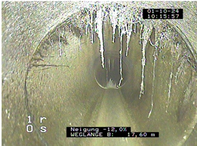
Wurzeleinwuchs und verschobene Rohrverbindung
