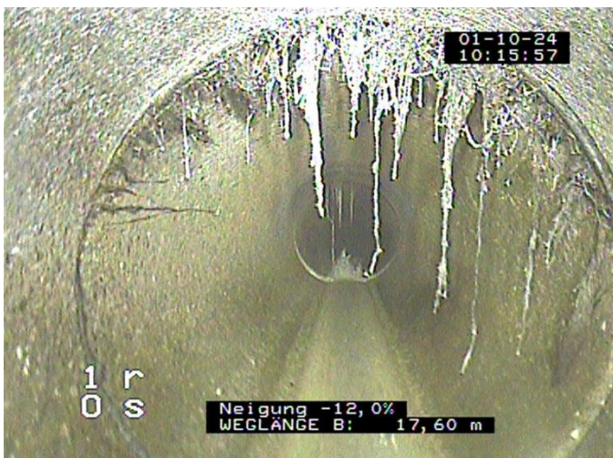
Wurzeleinwuchs und verschobene Rohrverbindung
