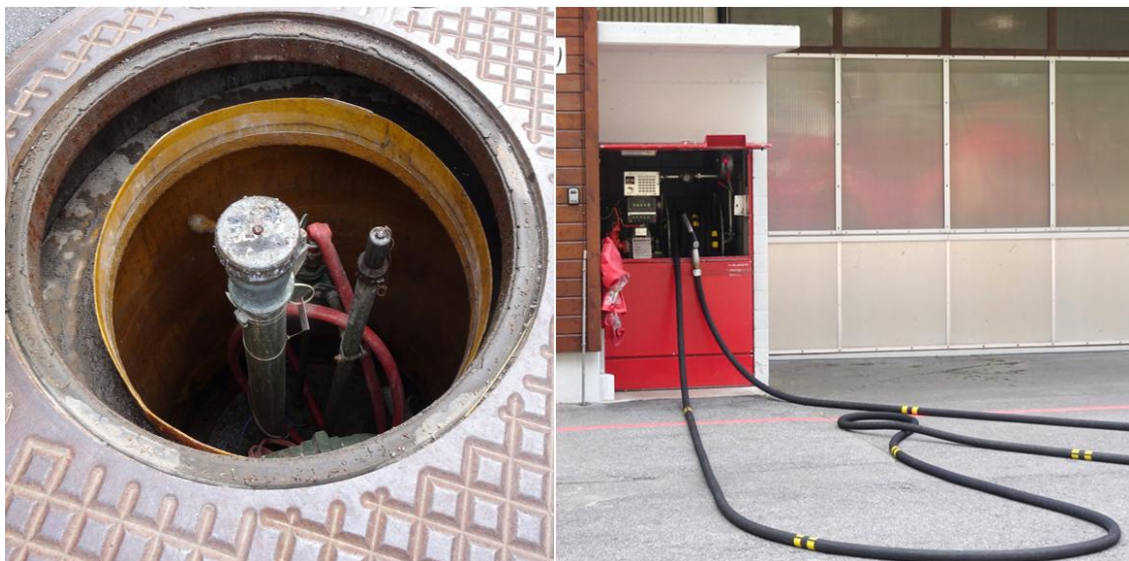
Abbildung 2-28: Links: Schacht mit Zapfschlauch des unterirdischen Kerosintanks, rechts: Zapfsäule an der Hangarfassade, Bächtold & Moor AG, 16.04.2024
