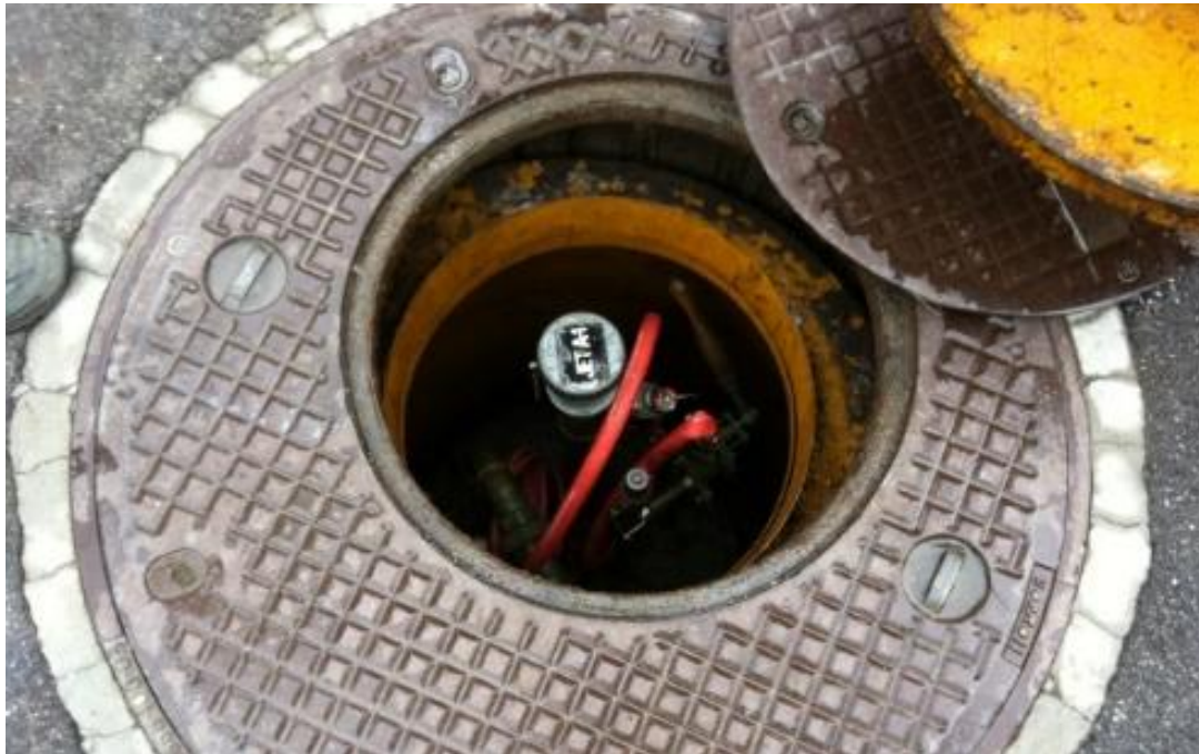
Abbildung 2-20: Schacht mit Zapfschlauch des doppelwandigen Kerosin-Lagertanks. Bächtold & Moor AG, 16.04.2024
